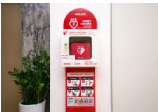
AED 應安裝於牆面
