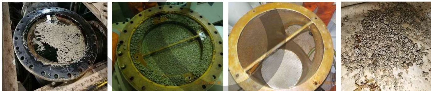
清潔受浮石阻塞元件（外航海運事業者 提供）
